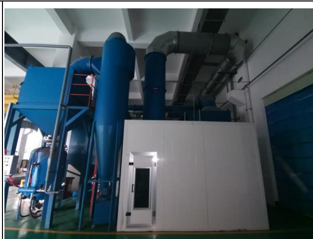
图 3-4j 打砂粉尘处理设施
