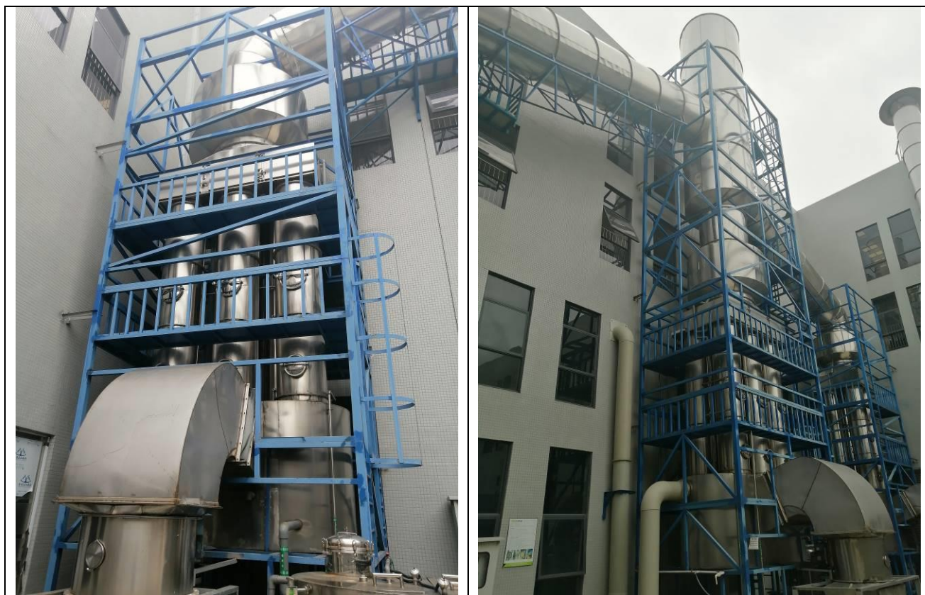
图 5-4 超氧纳米微气泡装置
