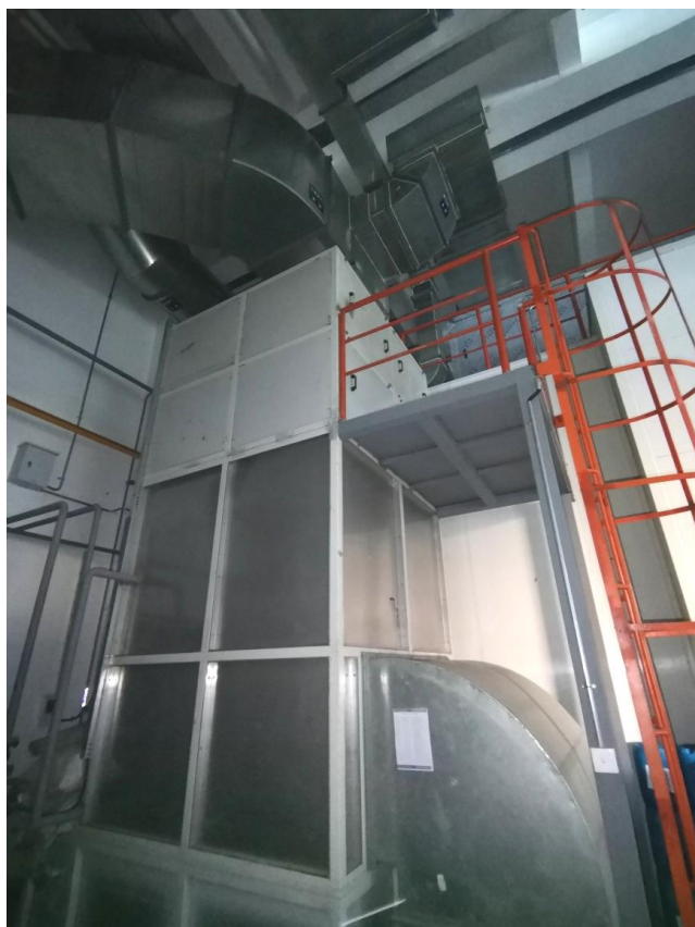
图 3-4m 打磨腻子粉尘处理设施
