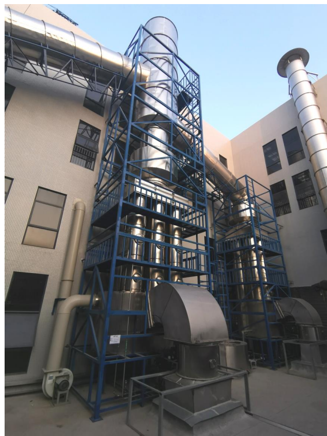
图 3-4n 喷漆废气处理设施
