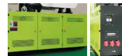
Armário elétrico limpo, seguro e fácil de manutenção
