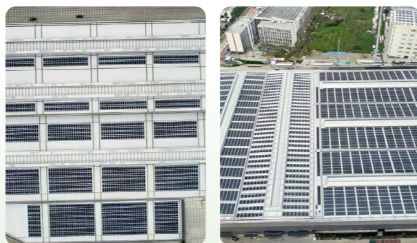
工厂光伏铺装
